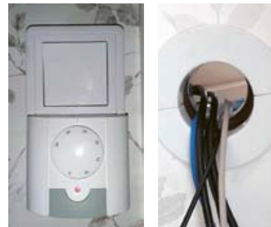
Vasemmalla ylempänä katkaisin, josta katkeavat virrat makuuhuoneesta. Sen alla kuvassa on lattialämmön säädin.
